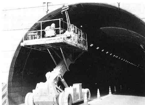
トンネル覆工背面空洞調査装置全景
