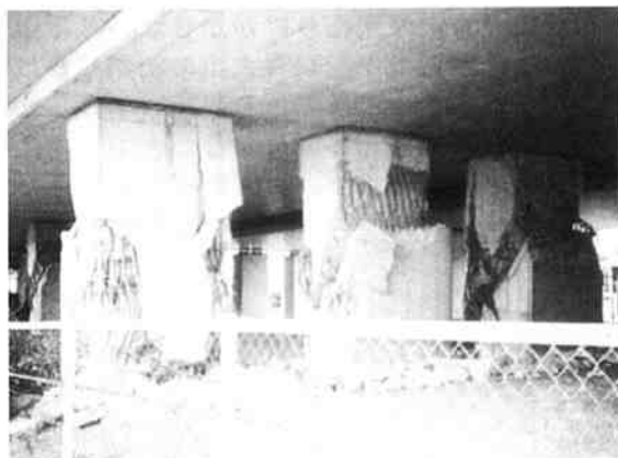
中国道 宝塚高架橋の橋脚の被害状況
