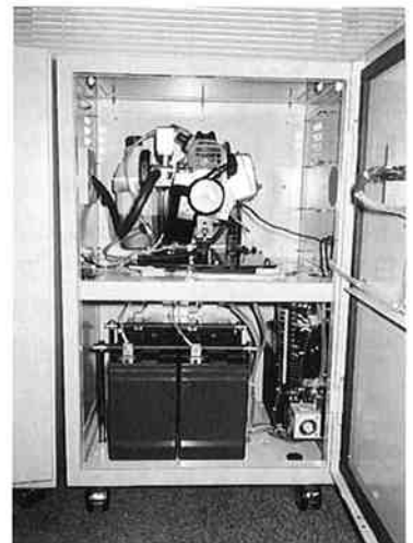
防災用システム発電機（LPG）
